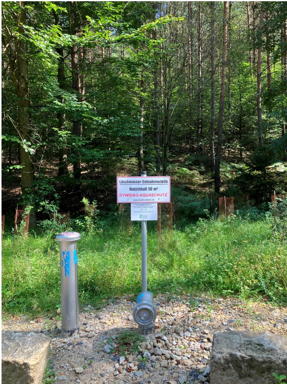
Bild 1: Löschwasserzisterne an der Lehne (50m³ an Löschwasser).
