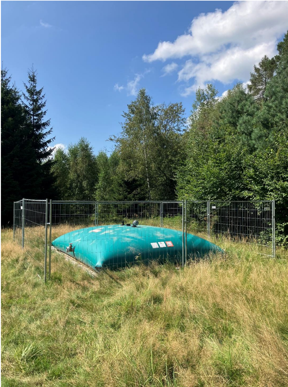
Bild 12: Mobile Löschwasserzisterne, Reitsteig (Stand: 20.08.2024).
